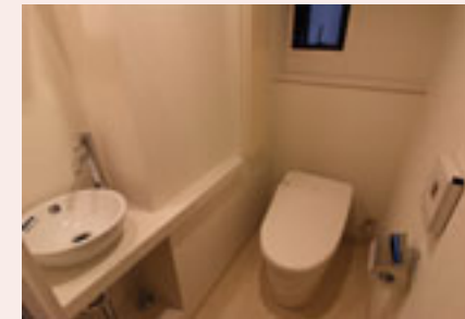
タンクレストイレを採用し、出来たスペースに手洗いを設置いたしました。
